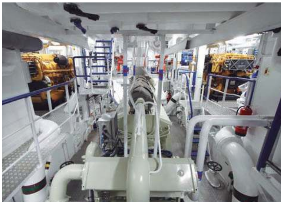
> Aspecto de la sala de máquinas.
